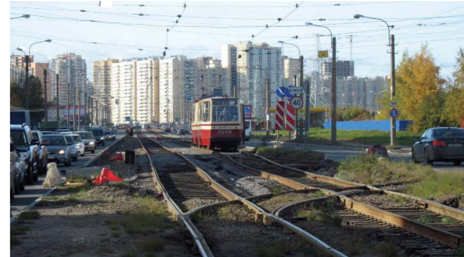
«Качественный» ремонт трамвайного пути. Санкт-Петербург, ул. Маршала Казакова
